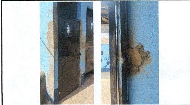
FOTO 2: Mantenimiento de estructura de puertas de metal (lijado, cambio de marco y aplicación de pintura). La pared se encuentra agrietada y los marcos no son anchos para sujetar cada puerta.
