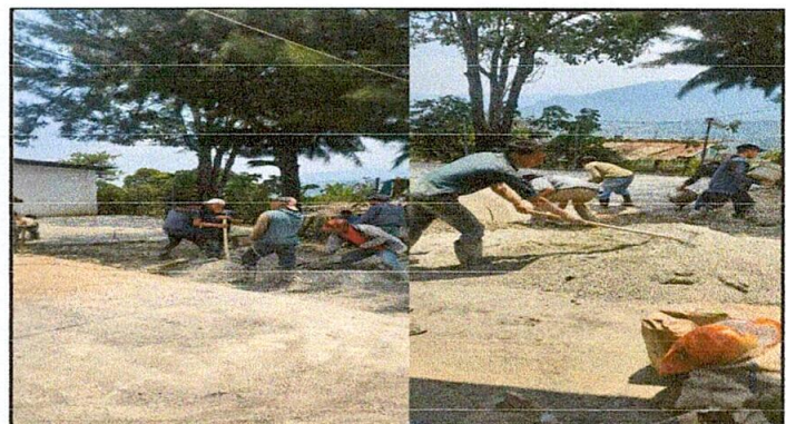
Foto 4. Se puede observar la mano de obra de padres de familia para la implementacion de una parte de piso de concreto la cual con aporte económico se pudo adquirir y complementar algunos materiales
