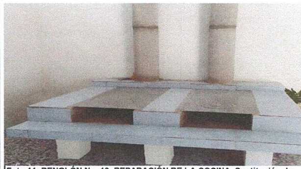
Foto 11: RENGLÓN No. 10. REPARACIÓN DE LA COCINA, Sustitución de estufa rural (completa) incluye chimenea y plancha de metal (Estufa rural de la cocina)
