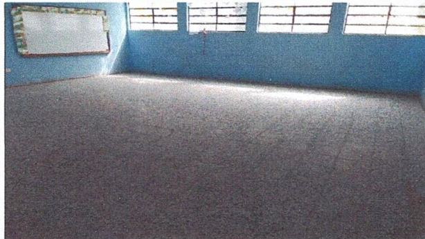
Foto 7: RENGLÓN No. 6. PISO, Sustitución de piso de granito (Pisos de las aulas)
