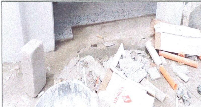
Foto 8: RENGLÓN No. 6. PISO, Sustitución de piso de granito (Piso de la cocina)
