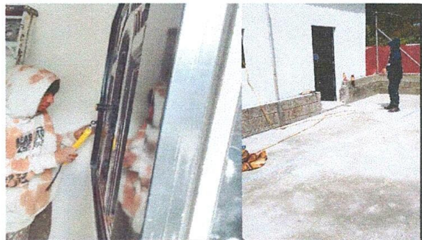
Foto 4: RENGLÓN No. 3. PUERTAS DE METAL, Sustitución de puerta (Puerta de la cocina)
