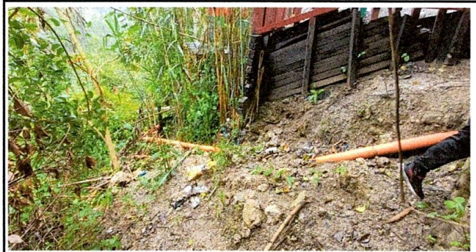
Foto 20: Red distribución de aguas negras del establecimiento remozado.
