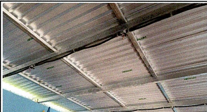
Foto 1: Evidencia Fotográfica de sustitución de cambio de techo de lámina troquelada aluzinc calibre 26 y tubos de soporte de estructura de metal
