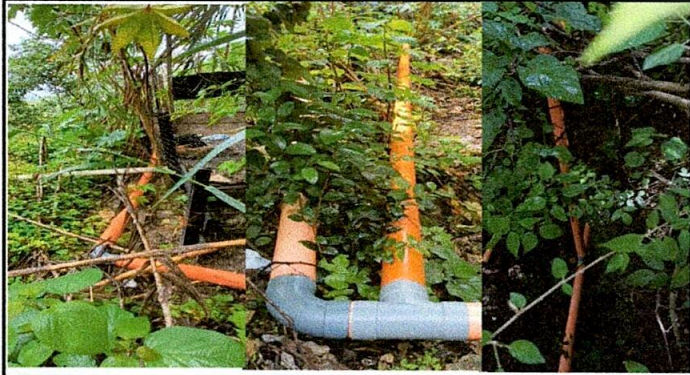
Foto 19: Reparación completa de las conexiones de la red de drenaje del centro educativo
