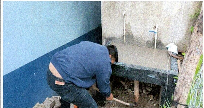
Foto 16: reparación de red de drenaje del centro educativo en proceso a remozar
