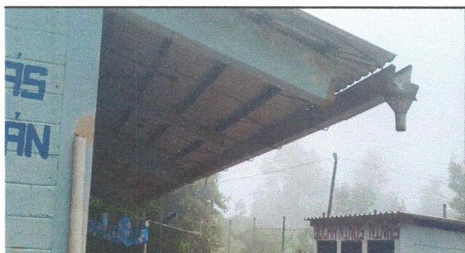
FOTO 3: Los canales están quebrados y los conos para recibir el agua están oxidados y otros ya se arruinaron completamente.
