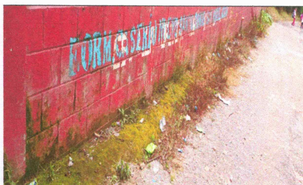
FOTO 4: daño por la humedad, se pretende aplicación de pintura
