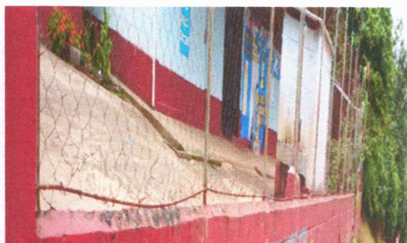
FOTO 6: Malla de muro perimetral en malas condicione
