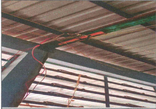
Foto 8: El cableado eléctrico se encuentra expuesto
