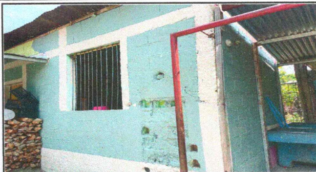
Foto 2: Vista de de ventanal en mal estado y exterior techo falso
