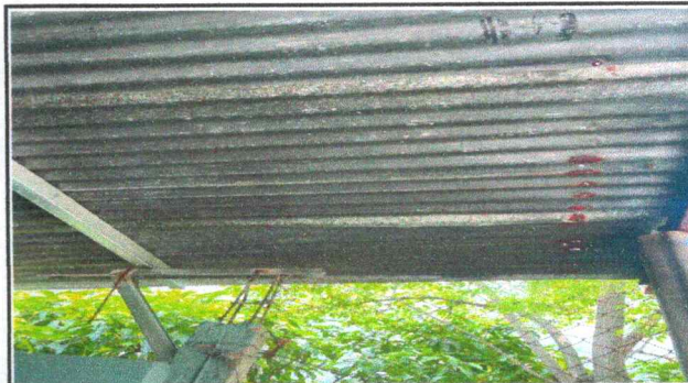
Foto 4: Módulo 2, estructura débil, falsa, lámina con filtraciones
