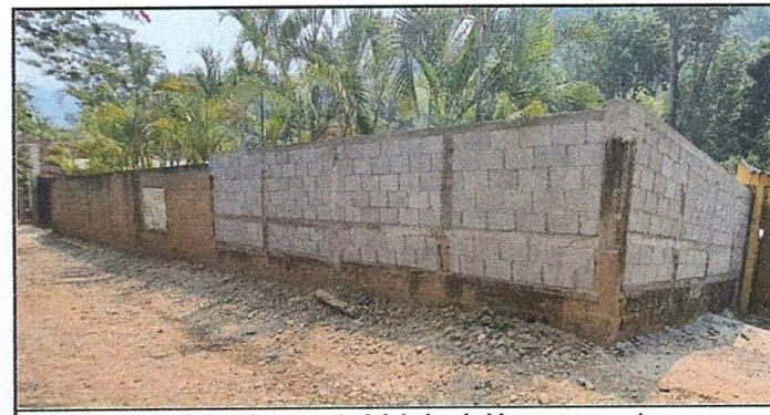
Foto 6: Muro perimetral con material de bock, hierro y cemento, reparación de columnas en mal estado. TERMINADO.
