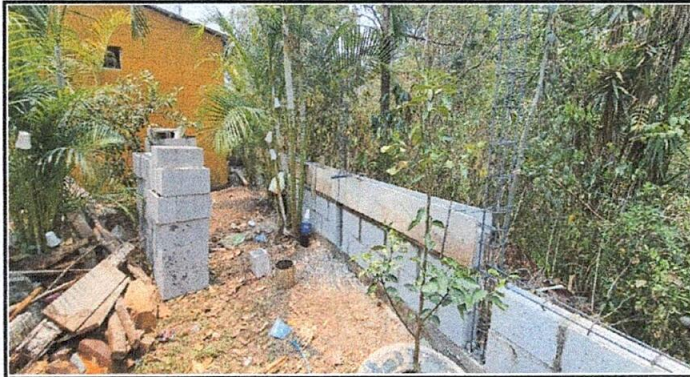
Foto 7: Instalación de muro perimetral con material de block, hierro y cemento. Reparación de columnas en mal estado.
