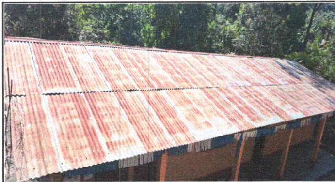
Foto 1: Estado actual del techo de las aulas de la escuela, toda la lámina tiene tapagoteras y se encuentra oxidada. Toda la lámina que cubre el techo de los ambientes de la escuela fue instalada hace 37 años.
