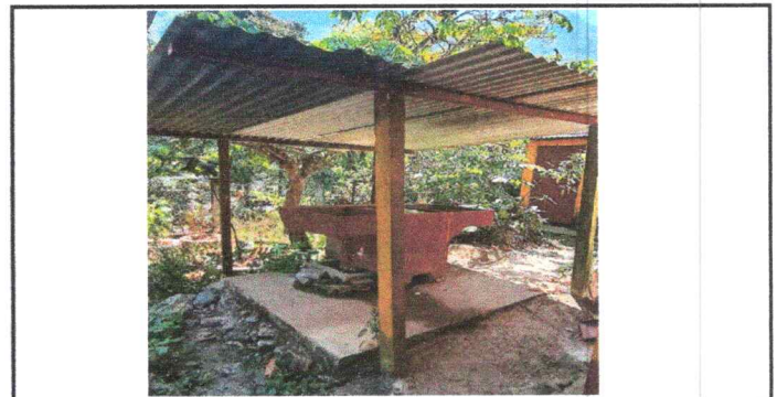
Foto 6: Estado actual donde se encuentra el área de lavado, la madera se encuentra apollillada, se necesita instalar costanera en los soportes verticales y horizontales, cambio de lámina.
