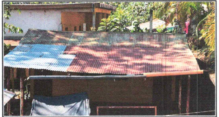
Foto 2: Estado actual del techo de la cocina, lamina con agujeros y oxidada, las caídas de agua en mal estado.
