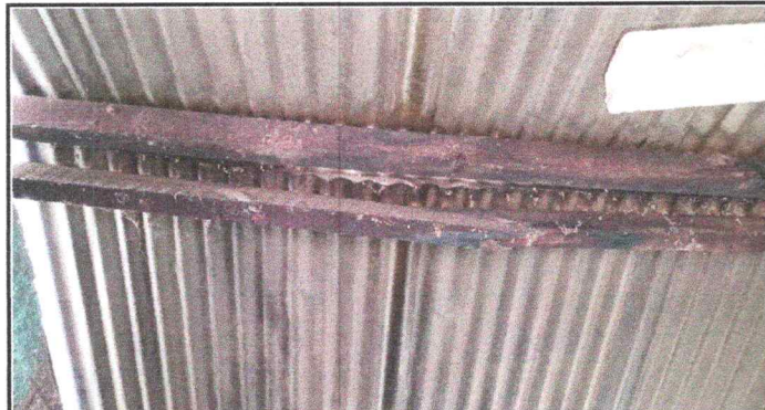
Foto 3: Estado actual del soporte de madera que tiene el techo de la cocina, se encuentra apollillada y en tramos quebrada, en cualquier momento puede provocar un colapso de la estructura.
