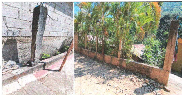
Foto 5: Estado actual del muro perimetral donde se necesita construir debido a que circulan vehículos y eso provoca que el polvo ingrese a las instalaciones provocando contaminación en las vías respiratorias.
