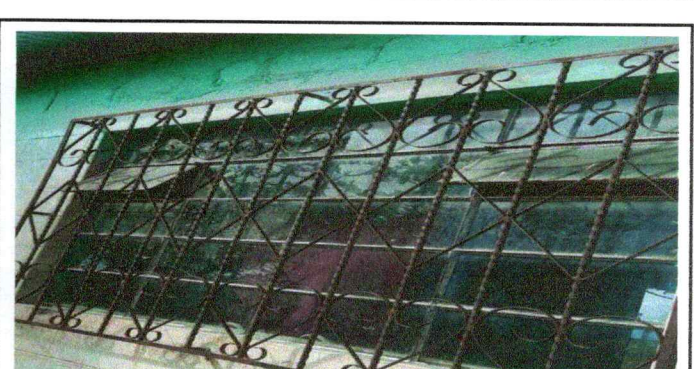
Foto 12: Sustrucción de balcones.
