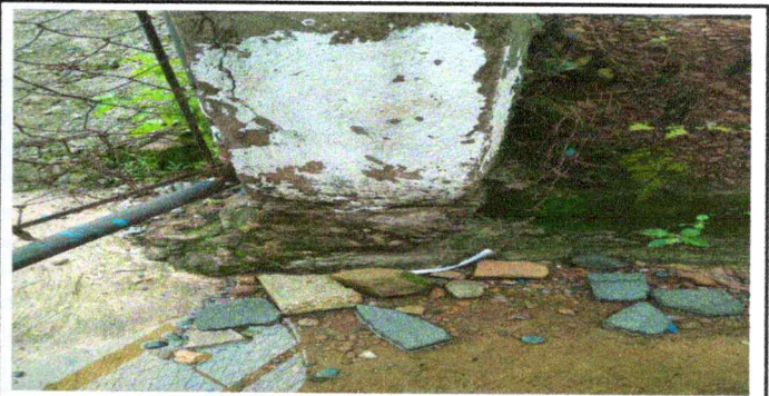
Foto 24: Sustrucción de poste de concreto perimetral
