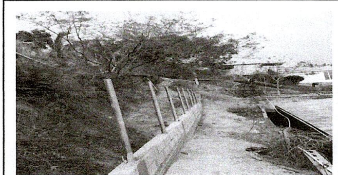
Foto 2: Continuidad de la fundición de columnas con tubos galvanizados para colocación de malla
