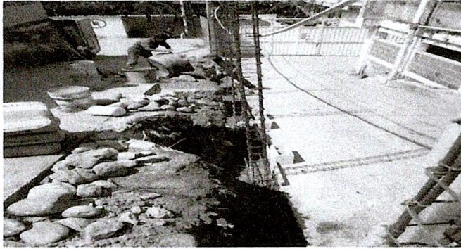
Foto 1: Destrucción del muro perimetral antiguo y comienzo de los trabajos del nuevo muro perimetral.
