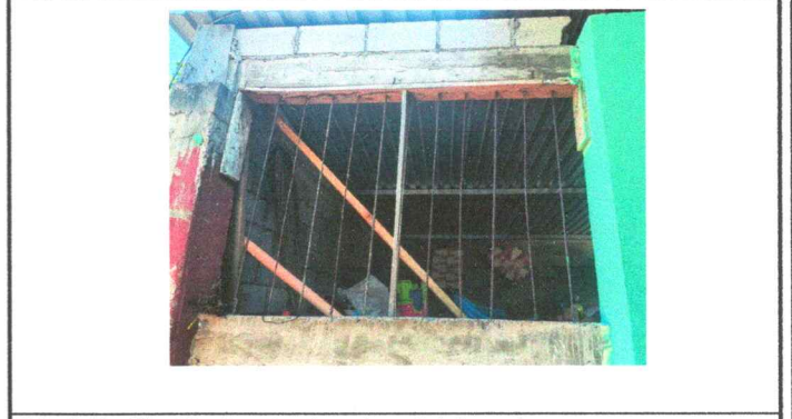
Foto 2: Sustrucción de estructura de metal de ventana
