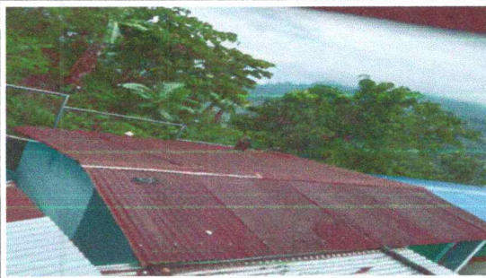
Foto 1: lámina y estructura de soporte de madera en malas condiciones
