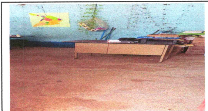
Foto 5: área donde se sustituirá piso cerámico
