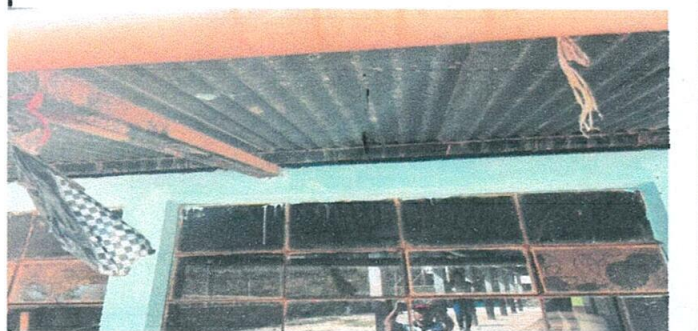
Estructura de soporte oxidadas y picadas
