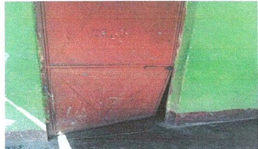
Foto 6: Puertas antiguas deterioradas
