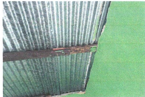
Foto 4: Vigas antiguas en mal estado
