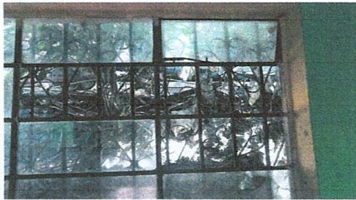
Foto 5: Ventana y balcones en mal estado, vidrios quebrados
