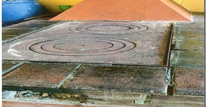
Foto 4: ESTUFA ARTESANAL EN MAL ESTADO
