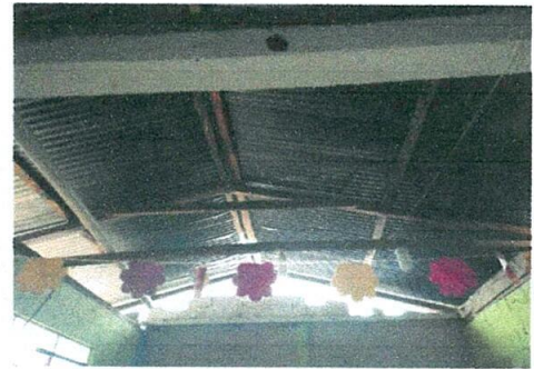
Foto 2: Sustrucción de madera por costanera metálica.
