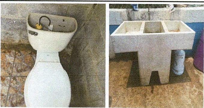
Foto 5: Servicios sanitarios y pila en mal estado.
