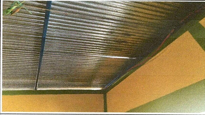
Foto 1: Situación actual de la lámina del aula en mal estado.
