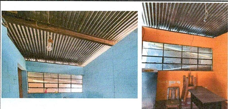
Foto 3: Láminas, instalación eléctrica, ventanas en condiciones pésimas, no aptos para la preparación digna e higiénica de la alimentación de los niños y niñas y en color naranja la Dirección con teja con agujeros.
