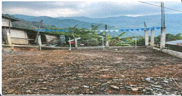
Foto1: en esta imagen podemos observar que ya se comenzó el trabajo en la reparación de piso de torta de concreto.
