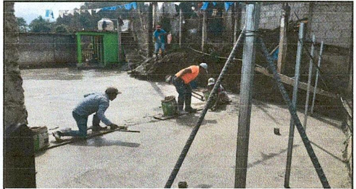
podemos observar a padres de familia trabajando en la fundición para la reparación de piso de torta de concreto.
