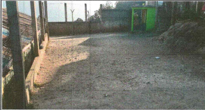
Foto1: En esta área es donde se necesita la reparación de piso de torta de concreto.
