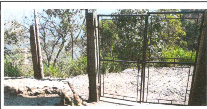
Foto 5: Foto 3: este es el portón que urge ser sustituido ya que se encuentra en muy malas condiciones.
