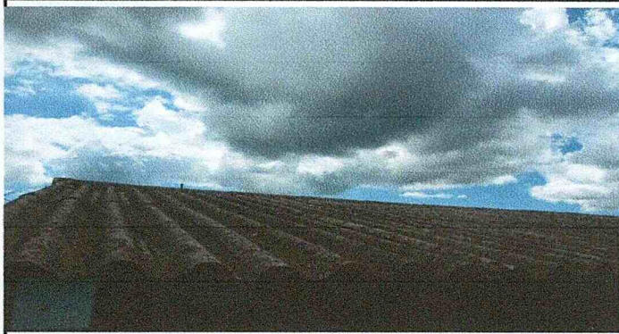
Foto 1: Techo de fibrocemento que se encuentra en mal estado
