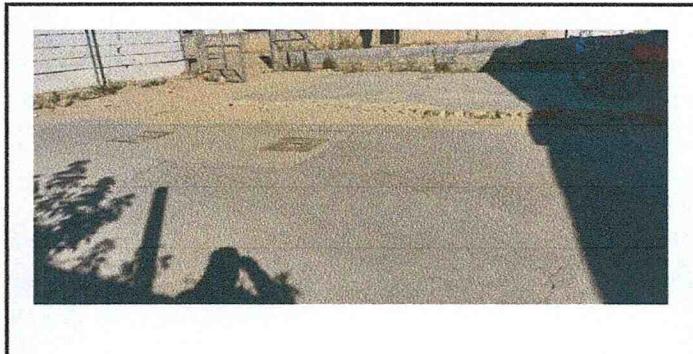
Foto 6: Patio de concreto en mal estado
