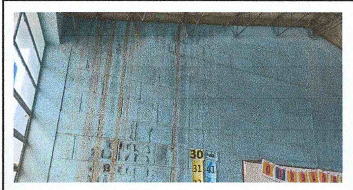
Foto 2: Bajada de agua en los techos durante Tormenta Pilar
