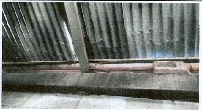
Foto 3: La lámina del techo se encuentra deteriorada
