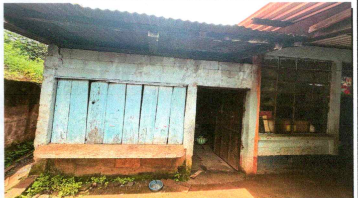
Foto 4: Nuestra cocina, se necesita remodelar por completo.
