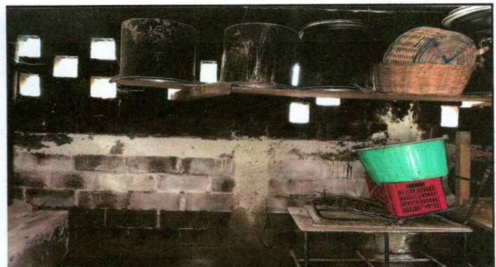
Foto 4: Los muros de la cocina necesitan ser repellados, pues la humedad se filtra y pueden derrumbarse.
