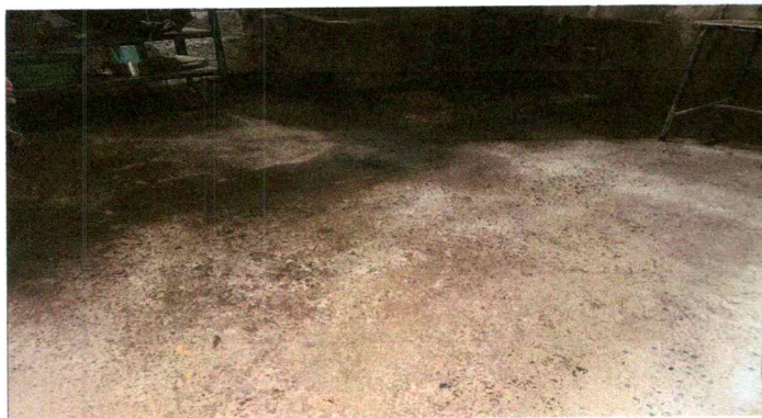
Foto 3: Torta de cemento estaba cubierta por cerámico a través del tiempo se fue destruyendo, pertenece a la cocina.
