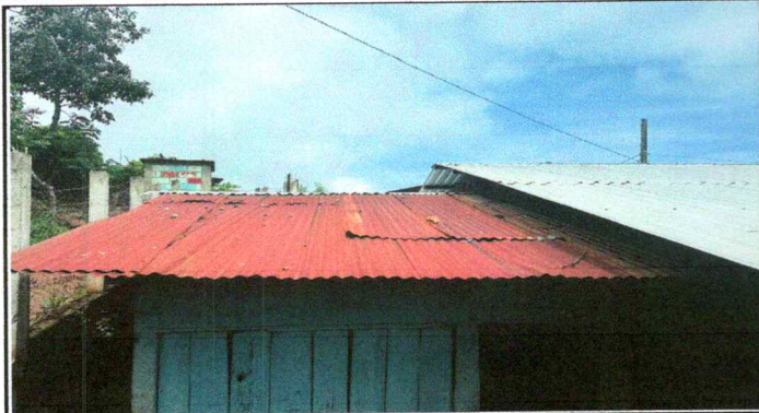
Foto 1: El techo de la cocina se encuentra inservible entra demasiada agua.
