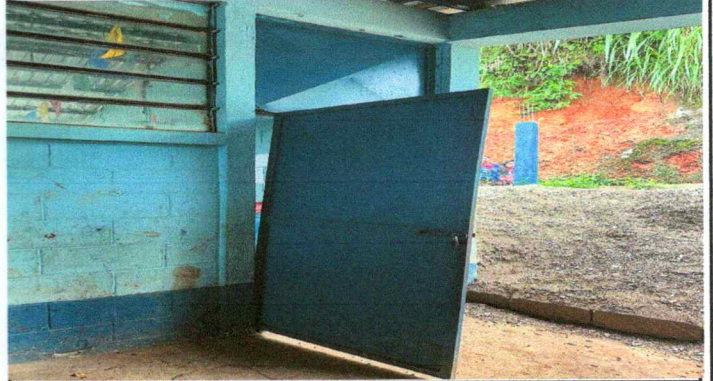
Foto 2: Esta puerta como las otras dos necesita cambiarse, pues están sujetadas con tornillos, causando inseguridad para los estudiantes, pues a cada rato se cae. la chapa ya no sirve y tienen demasiado óxido.
