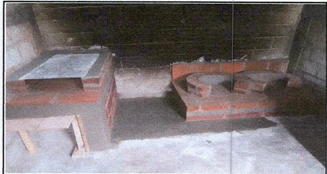
Foto 3: Sustitución de Estufa Mejorada
