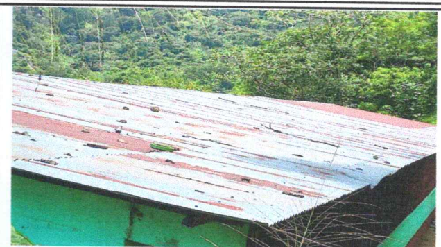
Foto 2: La lámina del techo se encuentra deteriorada
