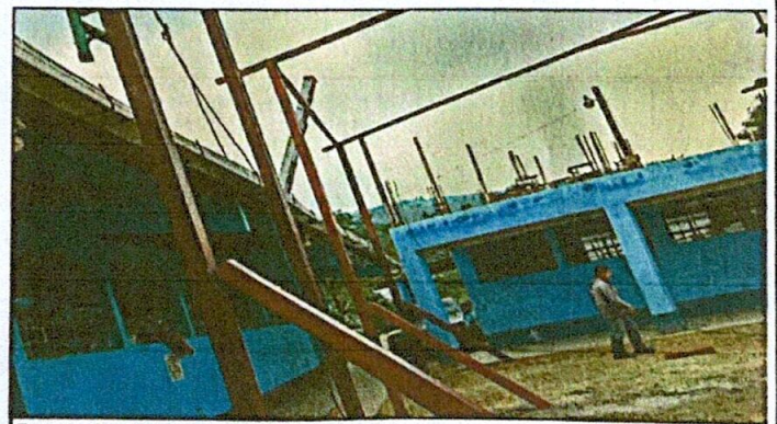
Foto 6: Sustitución de madera por costanera
