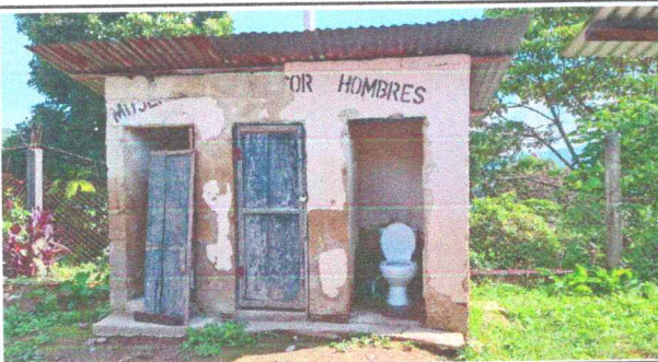
Foto 3: Falta puertas y repello de sanitarios
