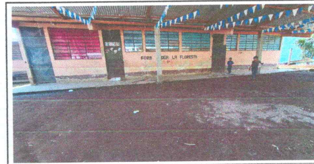
Foto 6: Falta de Pintura en paredes
