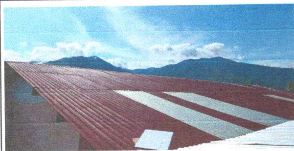
Foto 5: Techo en mal estado
