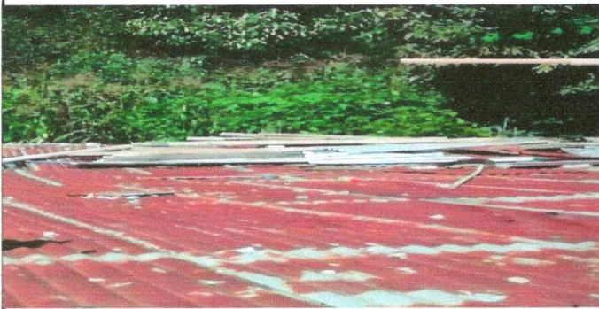
Foto 3: Techo en mal estado
