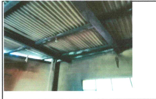
Foto 4: Lámina en mal estado
