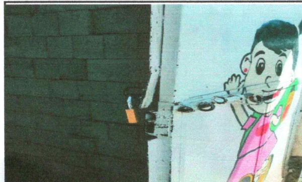
Foto 6: Portón en mal estado
