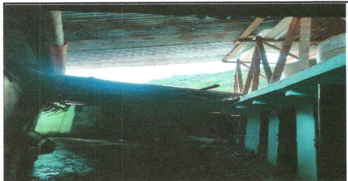
Foto 5: Techo en mal estado
