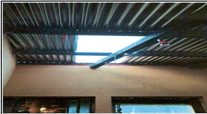
Foto 3: Sustrucción de elementos de fijación.
