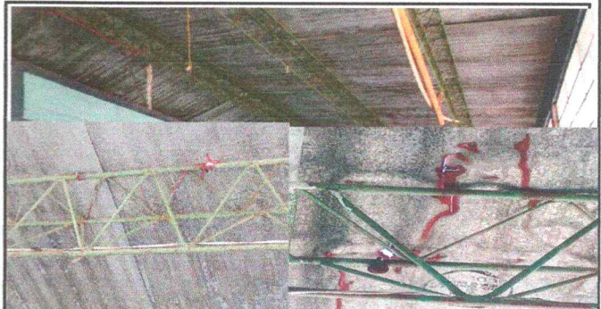
Foto 2: Daño en estructura de soporte de metal
