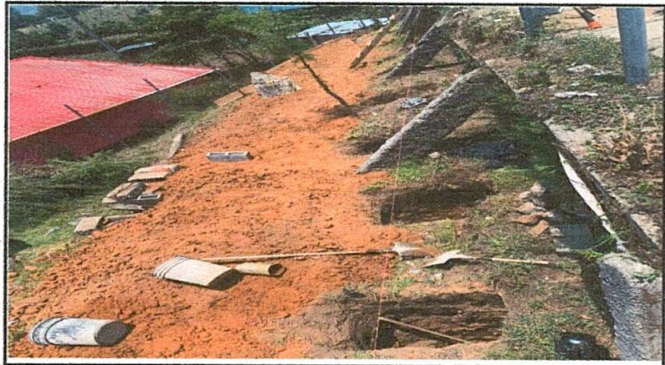
Foto1: Preparación de los agujeros en donde irán las colimnos de concreto que darán soporte al muro de contención.
