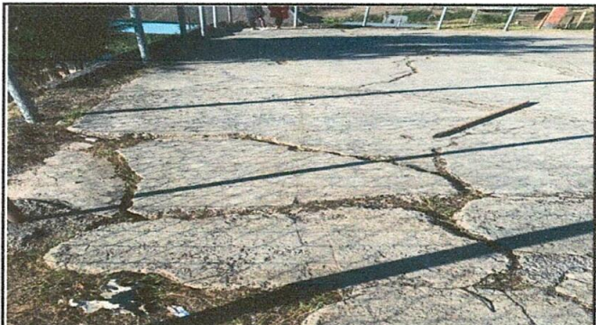
Foto 4: Debido a las fuertes lluvias de invierno pasado colapsó una parte del muro haciendo más peligroso el eminente derrumbe del mismo
