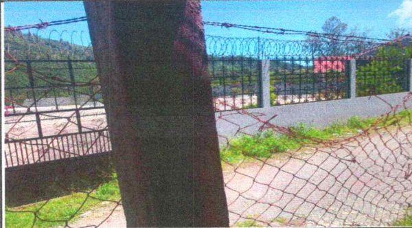
Foto 1: Sustrucción de malla en toda la escuela en malas condiciones
