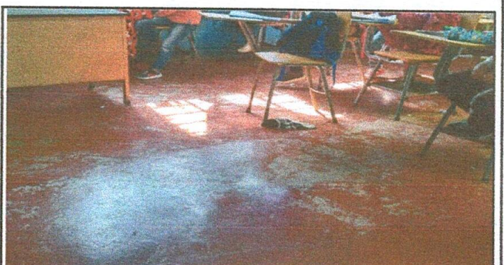
Foto 6: Piso en mal estado.
