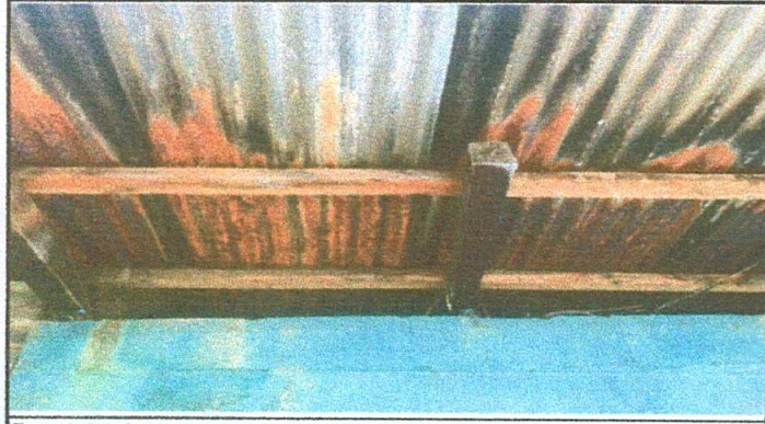
Foto 1: lamina con corrosión
