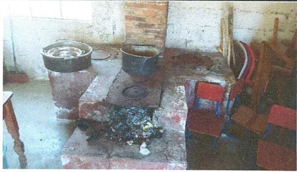
Deterioro casi total de la plancha para la preparación de alimentos, cocina,
