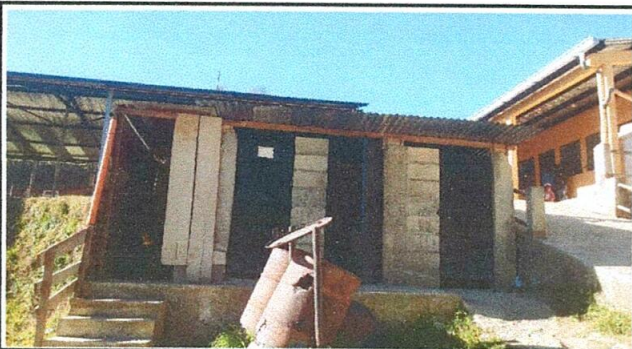
Batería de baños casi deteriorada, aun en funcionamiento.
