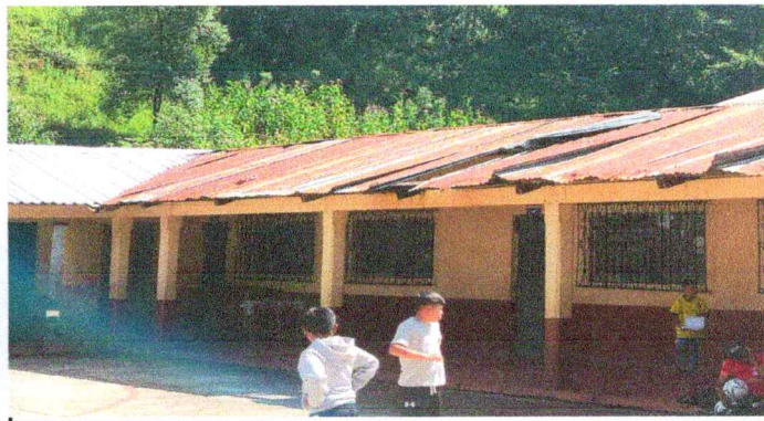
Foto 4: Abertura entre el techo
