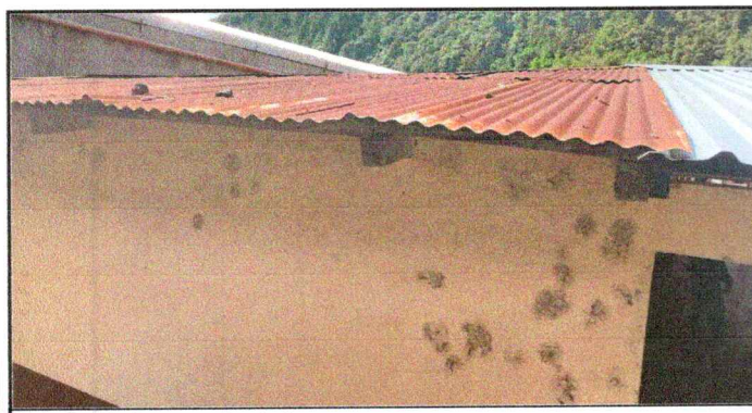
Foto 5: Techo en mal estado
