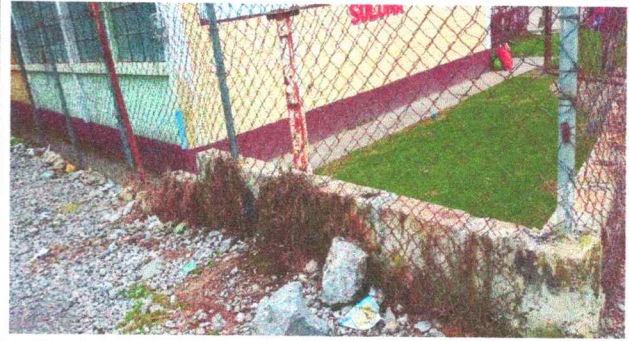
Foto 2: Muro perimetral en malas condiciones
