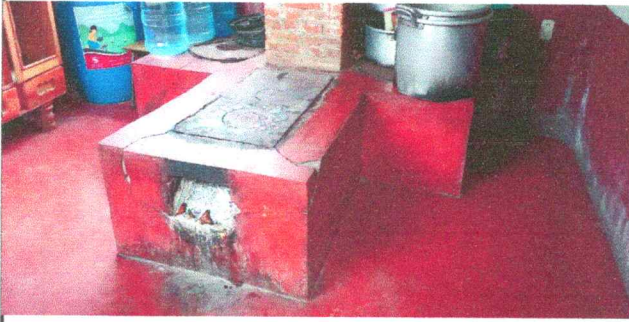
Foto1: Estufa en malas condiciones
