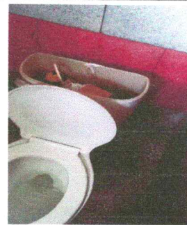
Foto 6: Inodoros en malas condiciones
