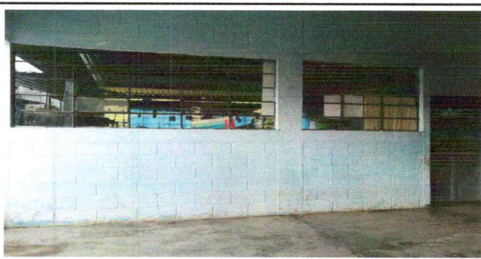
Foto 5: Parte fronta de una de las aulas que necesitan balcones.
