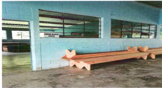
Foto 7: Aulas necesitan balcones y pintura.
