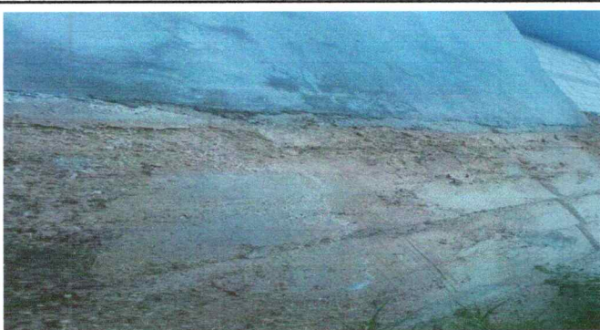
Foto 9: Muro de contención necesita repello y cernido.
