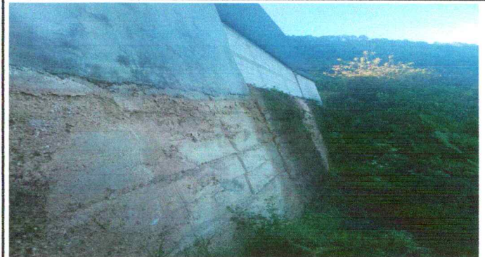
Foto 8: Penetración de humedad en espacios no repellados.
