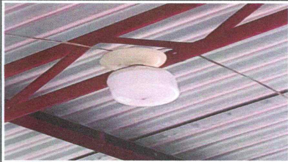
Foto 14: FOCOS DE ENTECHADO CON ACCESORIOS Y CONEXIONES INADECUADOS
