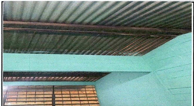
Foto 2: deterioro de vigas de madera y entechado con problemas de goteo
