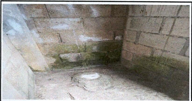
Foto 5: falta de tasas sanitarias
