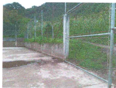
Foto 6: Es necesrio el mejoramiento de muro
