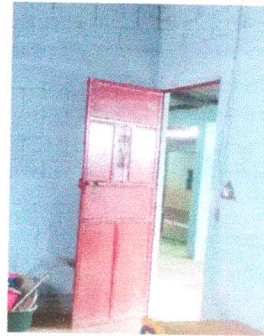
Foto 10: La puerta necesita su modificación por reparación de piso
