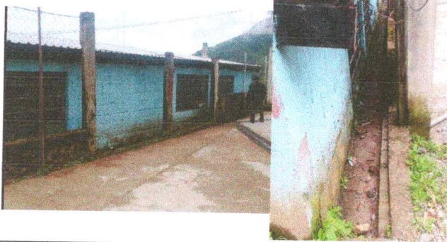
Foto 9: La caída de agua pluvial humedece la pared posterior de las aulas y cocina por lo que necesita su sistema de canal
