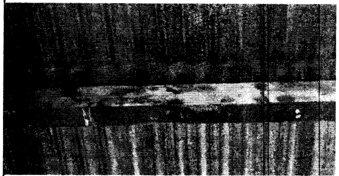
Foto 2: daño en techo
