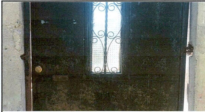
Foto 3: puerta metalica deteriorada
