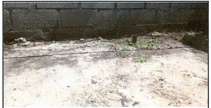
foto 6: piso de torta de cemento con fisuras y grietas
