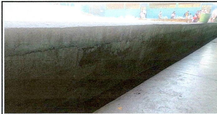
Foto 5: muro de contención a punto de desplomarse
