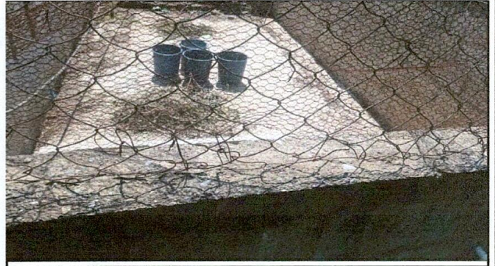
Foto 2: malla en mal estado como estructura de ventana
