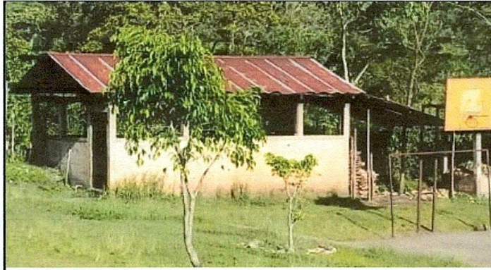
Foto 1: laminas de techo en mal estado
