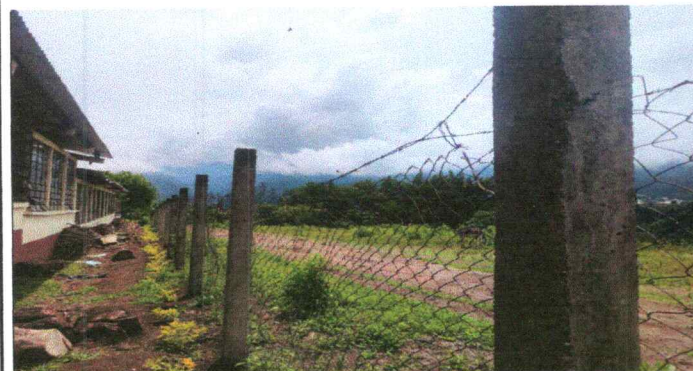
Foto 5: Malla deteriorada que necesita reconstrucción.
