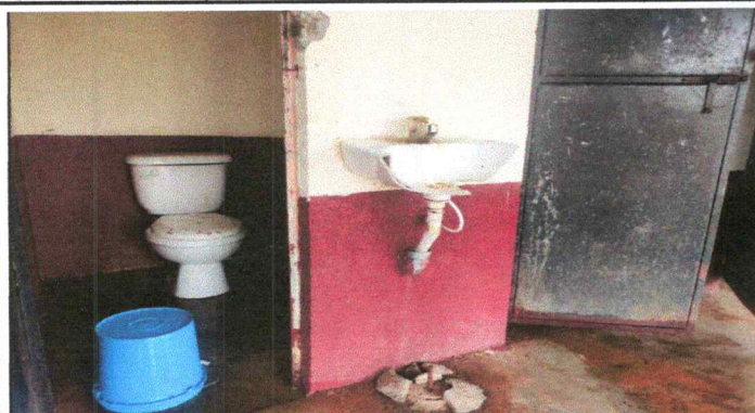
Foto1: Servicios sanitarios en muy mal estado.
