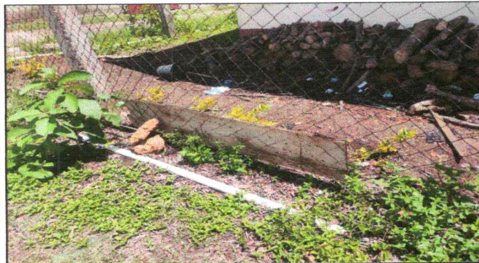
Foto 3: Malla deteriorada por el paso del tiempo.
