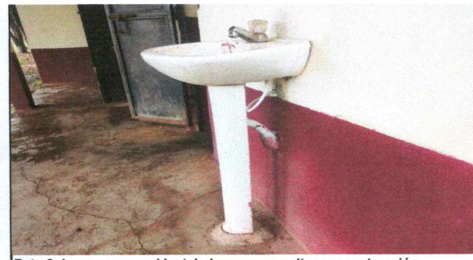
Foto 6: Lavamanos mal instalados que necesitan reconstrucción.
