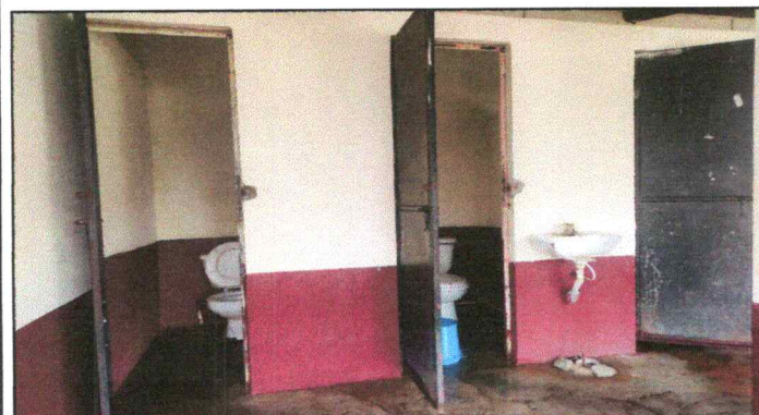
Foto 3: Necesaria remodelación de sanitarios.
