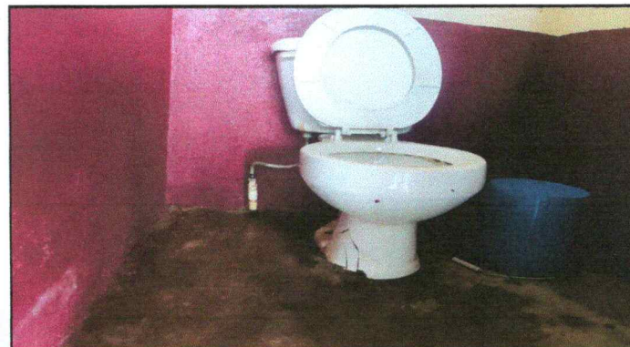
Foto 4: Sanitarios en muy mal estado.
