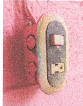
Foto 8: Instalación eléctrica en baños en mal estado.
