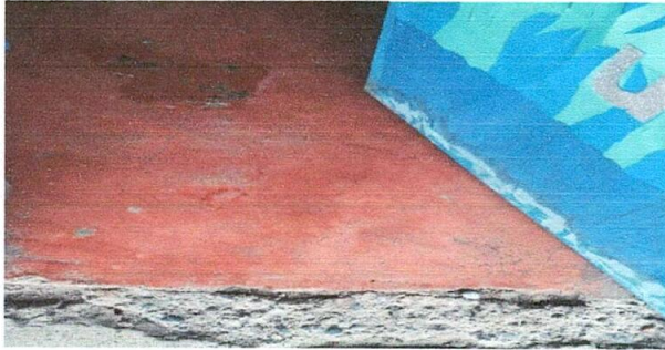
PISO DE TORTA AGRIETADO
